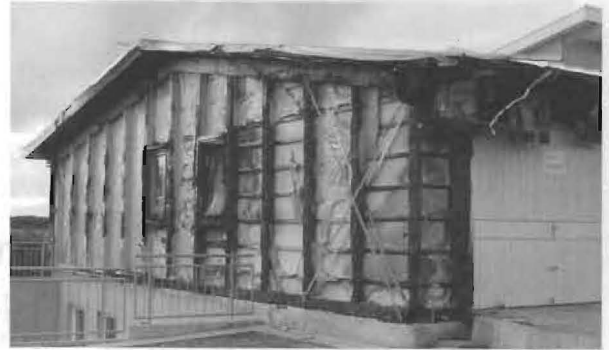
Die vom Feuer zerstörte Giebelseite des Vereinsheims. Das in diesem Gebäudeteil untergebrachte Inventar wurde durch die Hitzeentwicklung zum großen Teil unbrauchbar
