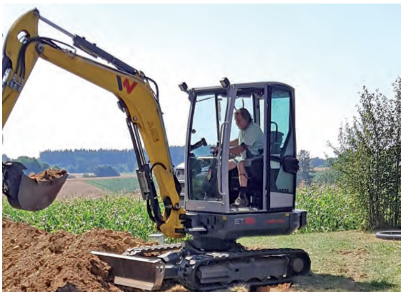
Johann Scharpf zog in gekonnter Manier den 70 Meter langen Graben für den Glasfaseranschluss
